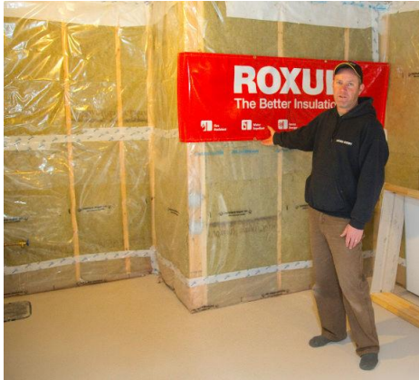
Jason Small, le gestionnaire du contrôle qualité pour Doug Tarry Homes. Il montre l'isolation et la barrière anti-moisissure hi-tech utilisées par dans les maisons Tarry, et qui empêchent la condensation. (Mike Hensen/The London Free Press/QMI Agency)
